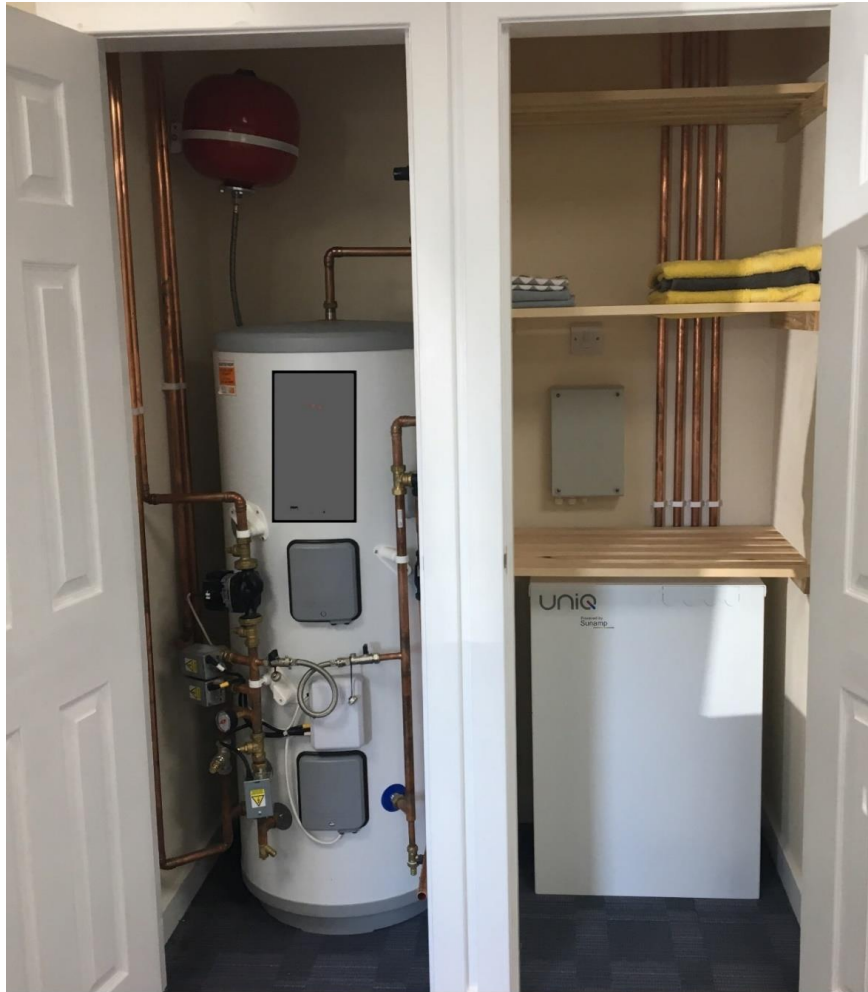
Zásobník teplé vody
